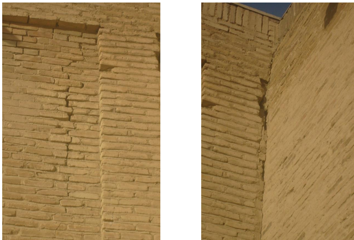
Рис. 3. Трещины в южной и юго-западных стенах комплекса.
