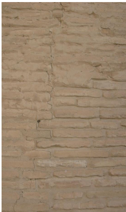
Рис. 5. Трещины в западной стене комплекса.
