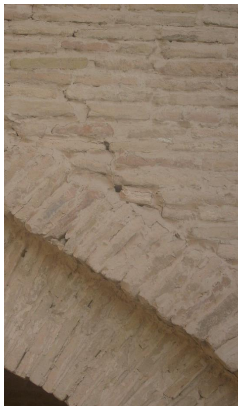
Рис. 6. Мелкие трещины в верхних частях арочного входа.
