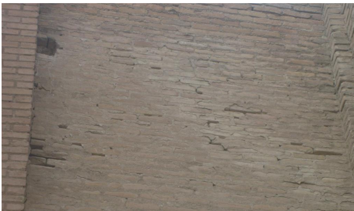
Рис. 4. Частичное выпучивание растворов из кладки стен комплекса Кусам ибн Аббаса (Западная стена).
