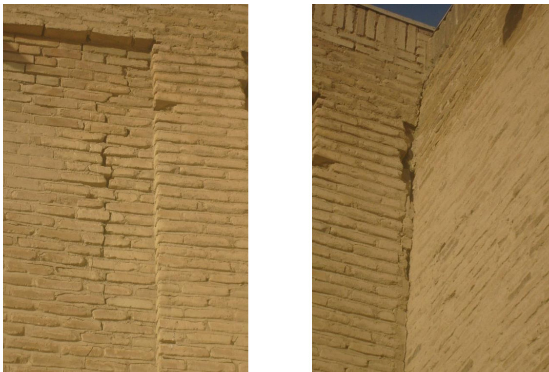
Рис. 3. Трещины в южной и юго-западных стенах комплекса.
