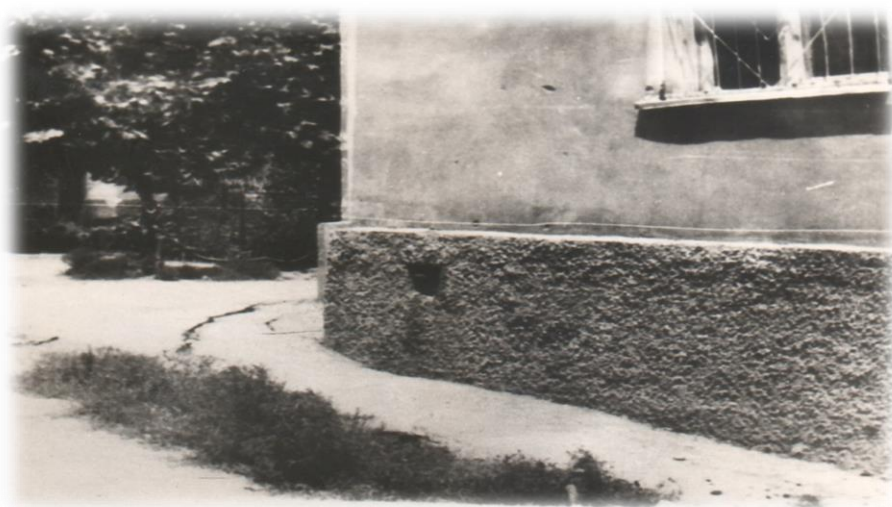
Рис.2 Деформация переувлажненных насыпных грунтов вокруг дома
