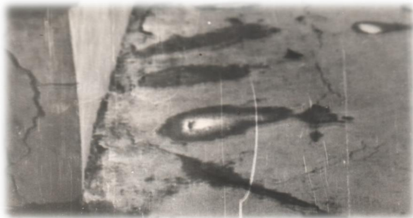
Рис.1 Трещины, образовавшиеся в цокольной части здания
