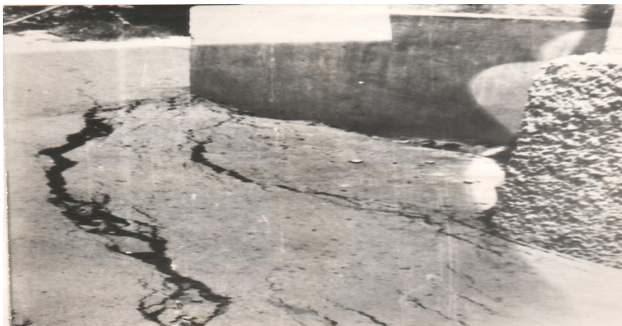
Рис.3 Выпор грунта из-под подошвы фундамента
