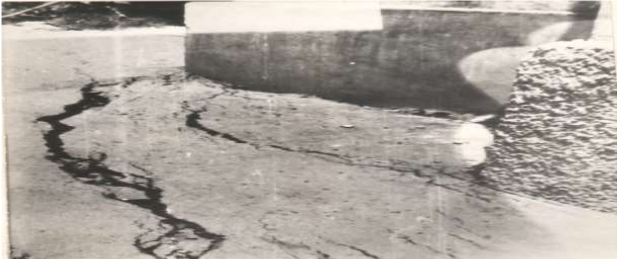
Рис.3 Выпор грунта из-под подошвы фундамента
